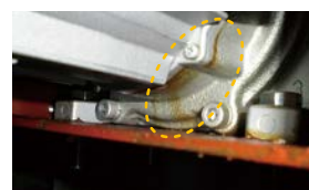
開閉機の油漏れ
