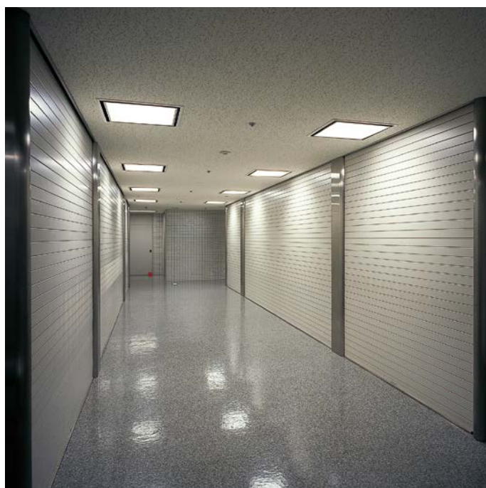
●防煙防火シャッター
